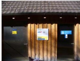
Trinkwasserkraftwerk Steia, Nendeln
